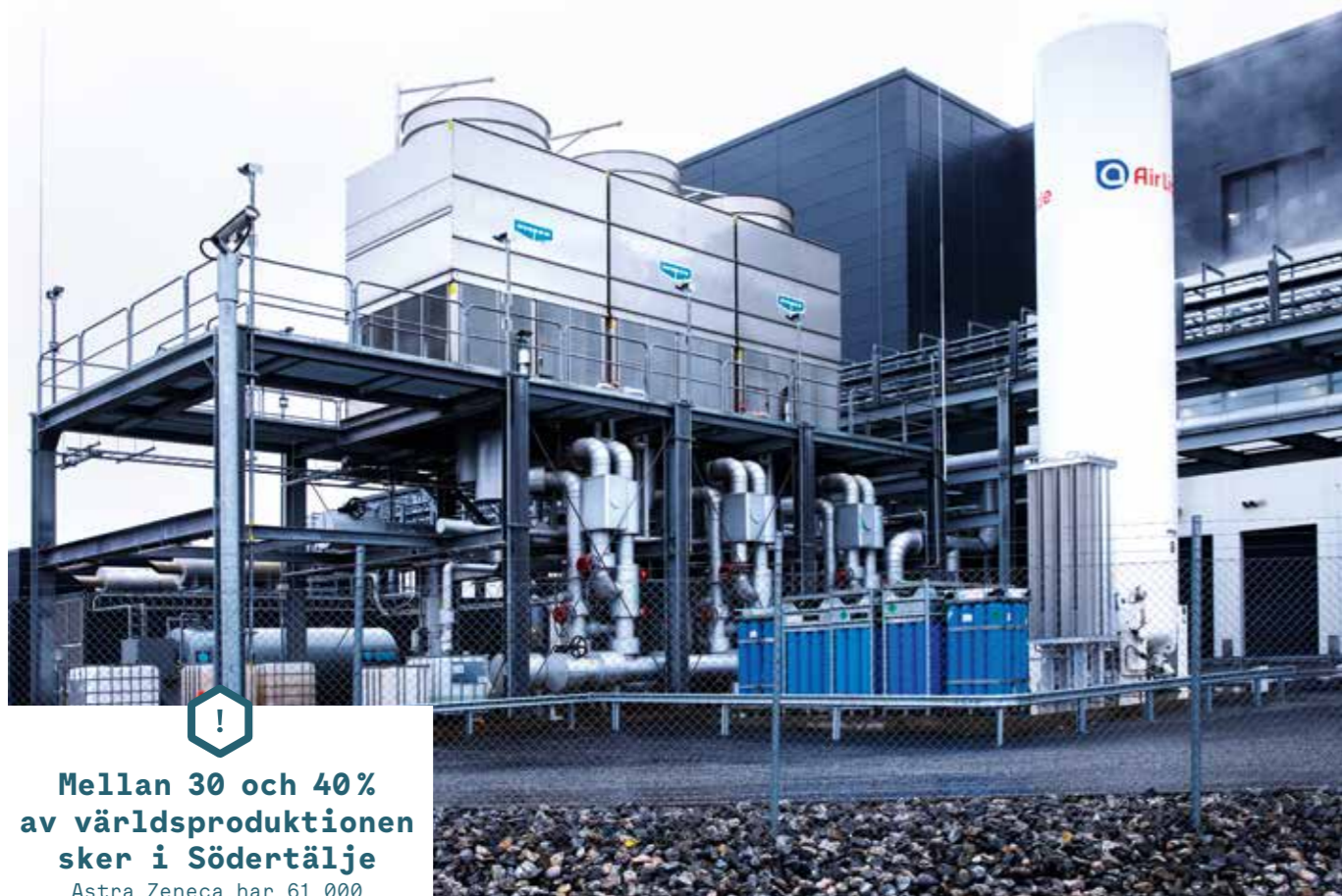
Kyltornen förser den nya anläggningen med kyla.
